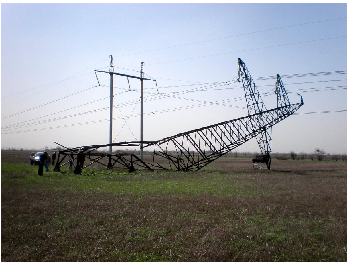
Рис. 2. Аварийная ситуация на ВЛ 330 кВ Н. Каховка-Джанкой в апреле 2013 года
