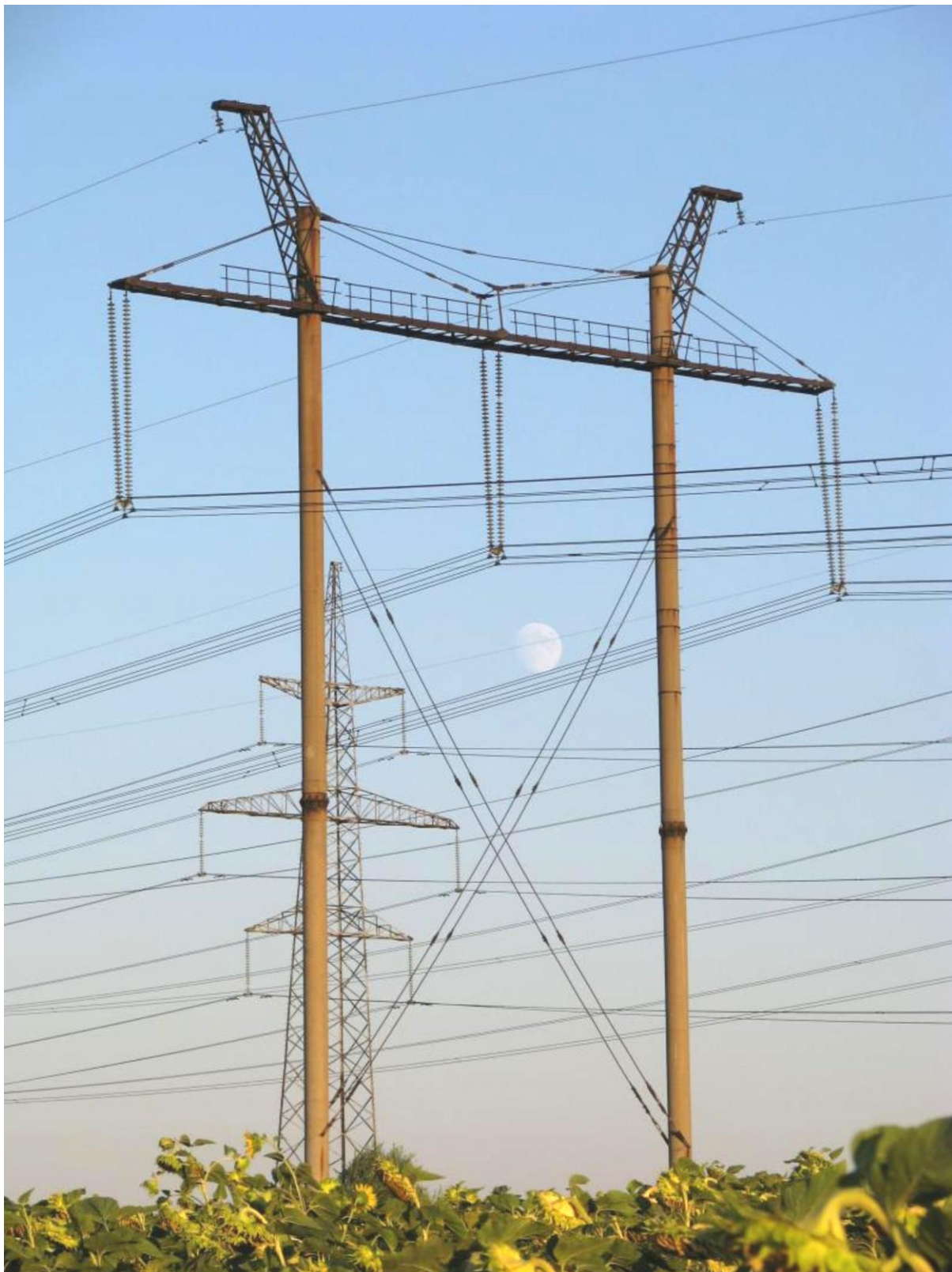
Рис. 1. ВЛ 750 кВ Запорожская АЭС – ПС Запорожская
