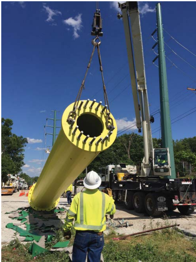
Рабочая бригада поднимает основную часть первой опоры и готовится установить ее на столбчатый бетонный фундамент.
