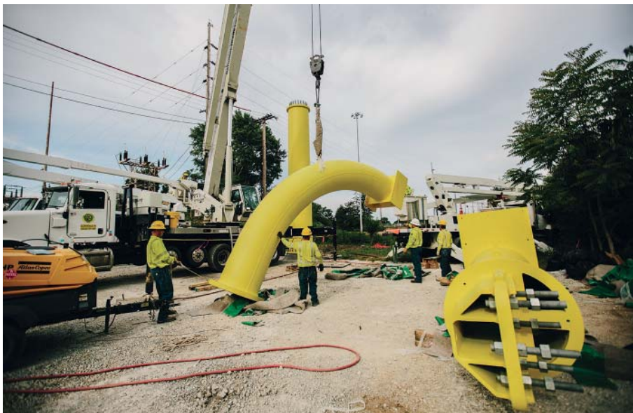
Рабочим приходится работать в команде и маневрировать изогнутой частью опоры перед ее монтажом при помощи специального подъемника.
