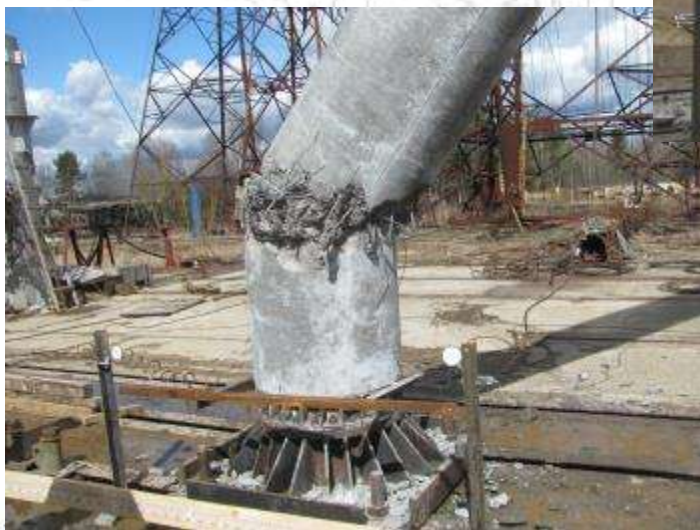
Разрушение стойки СЦС20 В 60.2 (160%)
