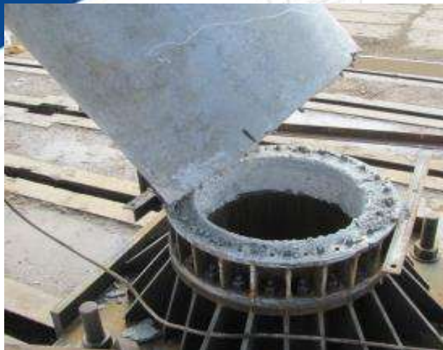
Разрушение стойки СЦС20 В40.1 (152%)
