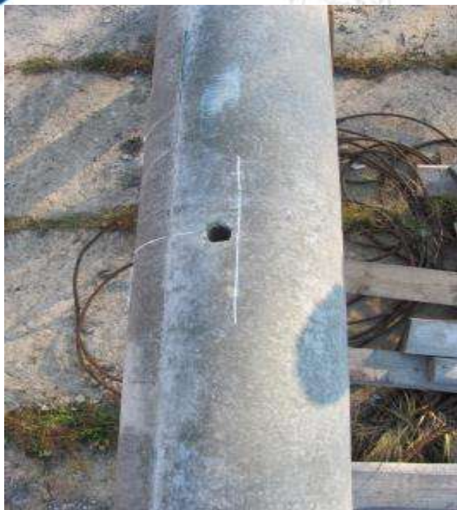
Отклонение закладной от оси стойки
