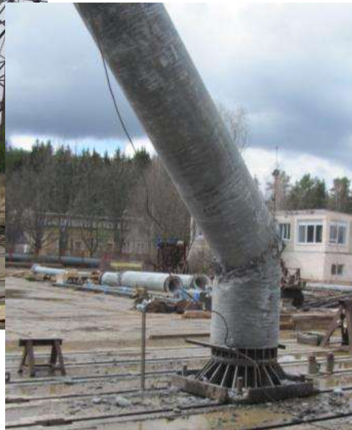
Разрушение стойки СЦС20В 40.2 (152%)
