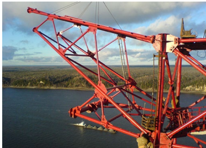
Рис. 1. Узлы переходных металлических опор АТ-105 на спецпереходе ВЛ 500 кВ через р. Ангару
