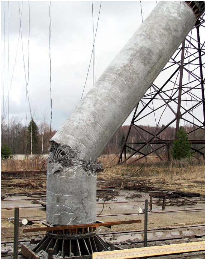
Рис. 3. Разрушение стойки при нагрузке в 160% от расчётного значения. Полигон в Хотьково 24 апреля 2015 года
